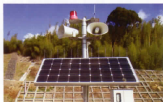
■場内放送設備(緊急地震放送等)
