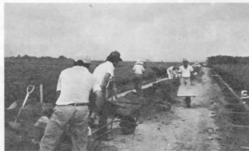
〔小山田地区道づくりの日〕59.8.26 町民出合いによるU字溝敷設工事 ＝堂ヶ山町にて
