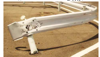
<ガードレールの損傷>
