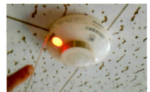
住宅用火災警報器の点検
