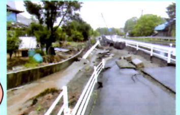
道路の断裂・陥没
