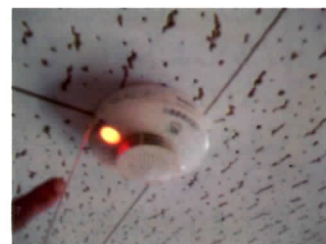
住宅用火災警報器の点検
